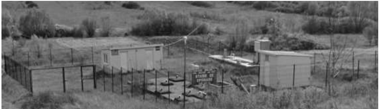
STAȚIA DE EPURARE SAT BARBOI
