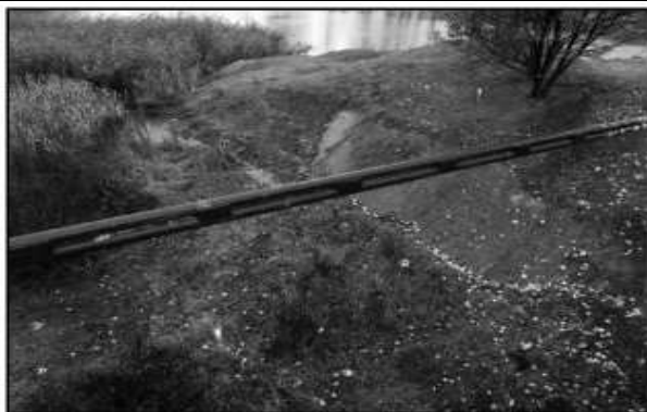
Descărcătorul de ape mari al barajului Tanchiștilor 1 spre canalul de NV – râul Amaradia
