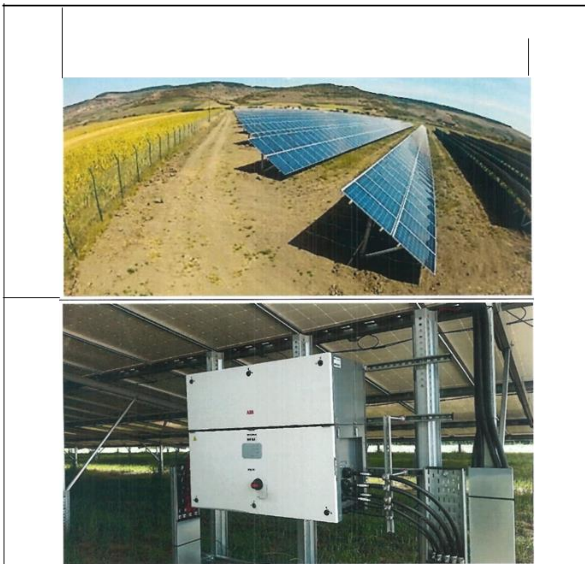
Fig nr. 1 – Amenajare panouri fotovoltaice, conexiuni
