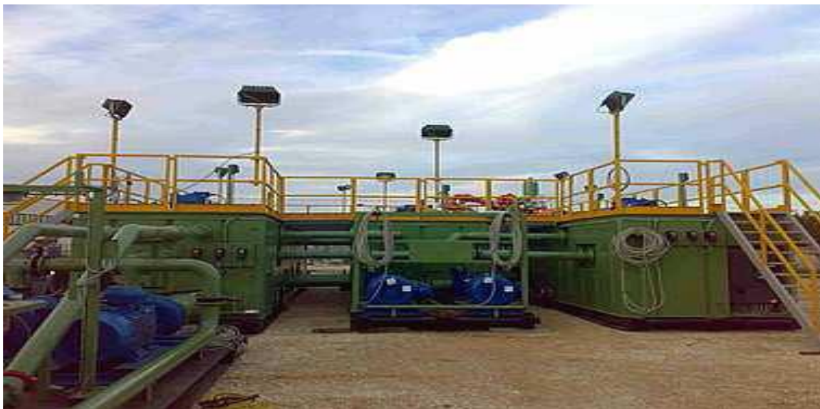
Sistemul de depozitare a fluidului de foraj la sonda
